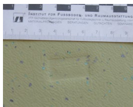
Schadensbild durch scharfkantigen Möbelfuß
