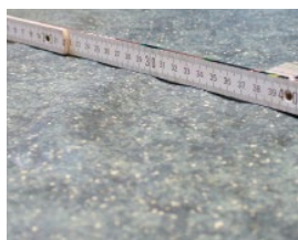
Zerstörung durch harte Rollen
